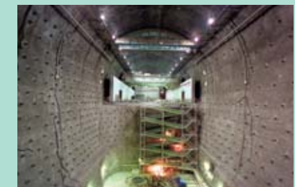
東京電力神流川発電所（建設時の様子） 写真提供：東京電力(株)
