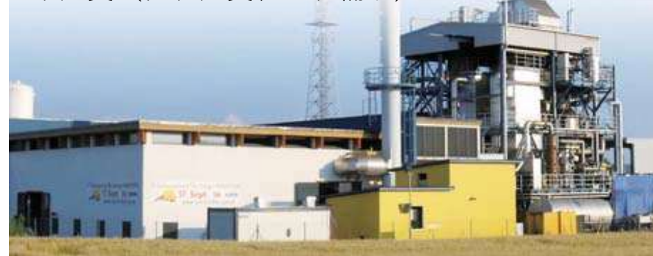
木材ガス化プラント
