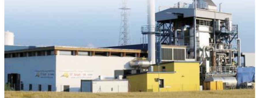
木材ガス化プラント
