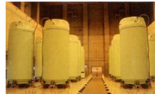
日本原子力発電 東海第二発電所での乾式貯蔵
