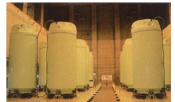
日本原子力発電 東海第二発電所での乾式貯蔵
