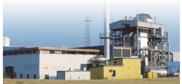
※木材ガス化プラント
